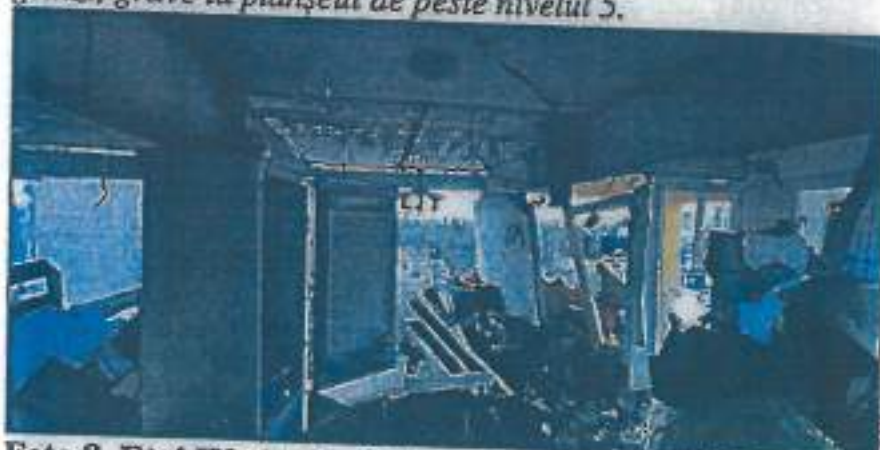
Foto 8. Etaj IV. Ap.31. Vedere cu pereții de umplutură dislocați, avarii moderate - grave la grinzele de cadru, avarii grave ale plăcilor prefabricate din b.a. ale planșeului de peste nivelul 5.
