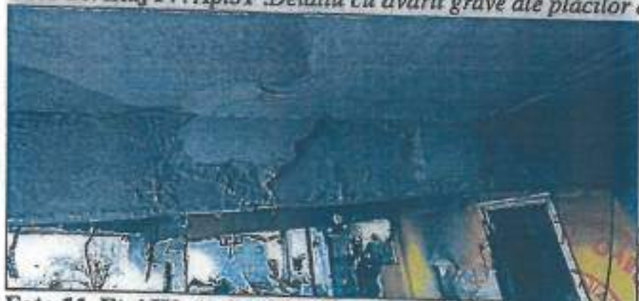
Foto 11. Etaj IV. Ap.31 .Detaliu cu avarii ale grinzilor prefabricate.
