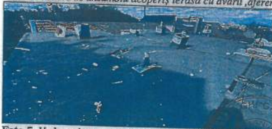
Foto 5. Vedere planșeu terasă avariat, prin încălțarea spre extrados, provocate de explozie, zona aferentă scării A.
