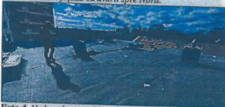
Foto 4. Vedere de ansamblu acoperiș terasă cu avarii ,aferentă zonei scării A.
